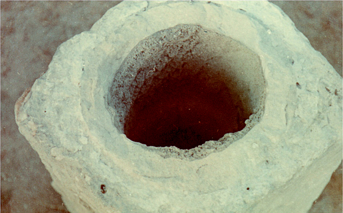
Kesselstein in den römischen Wasserleitungen
